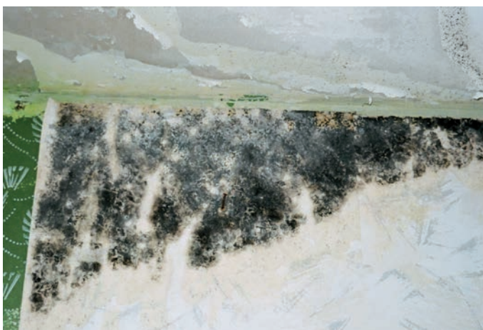
Il. 3. Grzyby pleśniowe na ścianie pomieszczenia pod sufitem - po „zalaniu” (autor).
