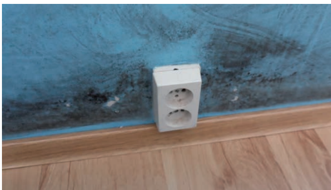
Il. 2. Grzyby pleśniowe wokół gniazdka elektrycznego oraz listwy przypodłogowej na parterze (autor).
